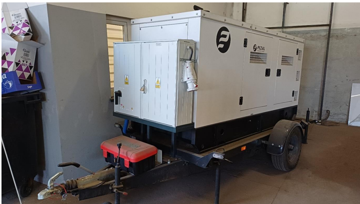
Zdj. 48 Agregat prądowórczy Pezal na przyczepie
